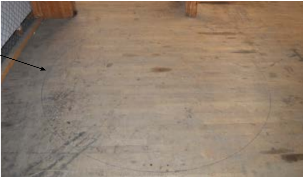
afbeelding 133. Twee details de uit voorgaande afbeelding. In de vloer voor de westgevel is een zone uit afwijkende vloerdelen aanwezig.
