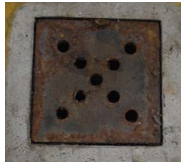
afbeelding 331. Twee details van de verschillende soorten afvoerroosters in de fabriekshal.
