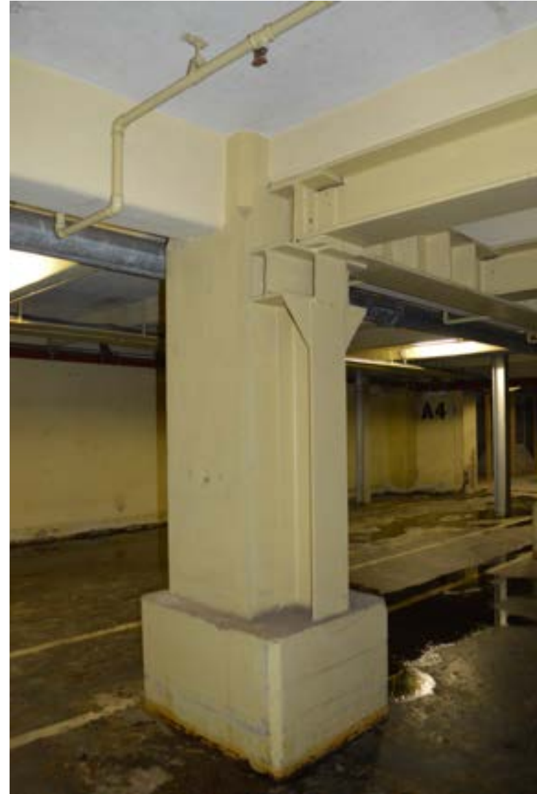
afbeelding 157. Detail van een kolom (1920); voorzien van een rechthoekige kolomvoet en aan de bovenzijde voorzien van een vellingkant. De constructie werd hier plaatselijk verstevigd met een stalen portaal.
