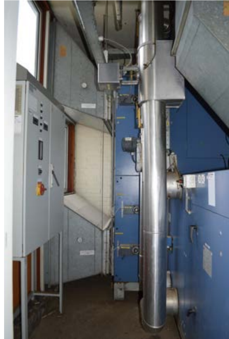
afbeelding 248. Installatieruimte 013 gelegen in de in 1959-60 gerealiseerde aanbouw tussen gebouw 4 en 6.
