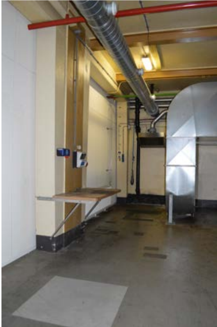
afbeelding 289. De voormalige werkplaats (083A) met luchtbehandelingsinstallatie. Langs de westzijde van de ruimte zijn diverse sporen in de vloer aanwezig, van latere dichtzettingen in de gegoten betonvloer. Aan de kolom werd een werkblad gemonteerd.
