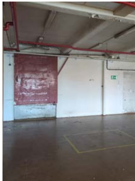
BRANDDEUR VAN GEBOUW 4 NAAR GEBOUW 6 (C)
