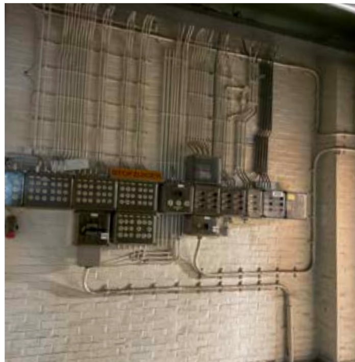
INSTALLATIES OP WANDEN
