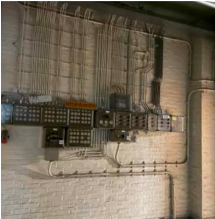
INSTALLATIES OP WANDEN
